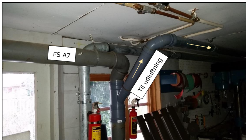
Figur 3-1. Billede af rørføringen ved udluftningen af faldstamme FS A7. Som det kan ses på figuren, fortsætter faldstammen efter afgreningen til luftafkastet. Bagerst ses udluftning til et afværgedræn under gulv. Denne rørføring indgår ikke i nærværende projekt.
